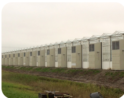
Récupérateurs de chaleur
