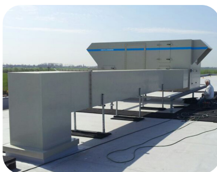
Conduite de ventilation
