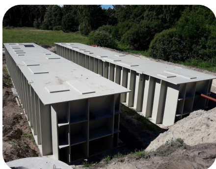
Traitement des eaux usées
